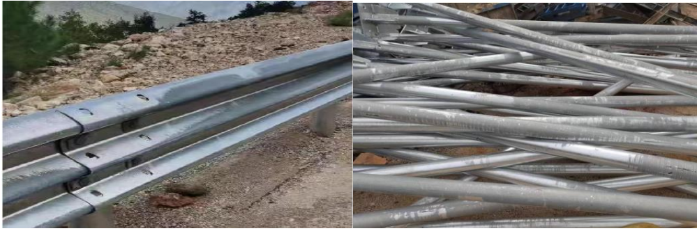
图 1 宜良银龙交通科技有限公司生产的产品出售后出现不同程度的表面脱落、氧化
