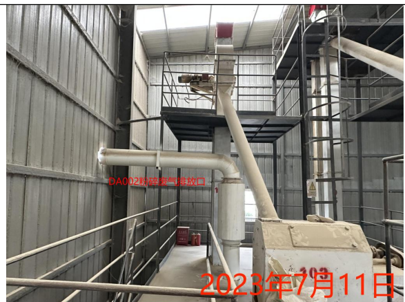
粉碎废气排放口
