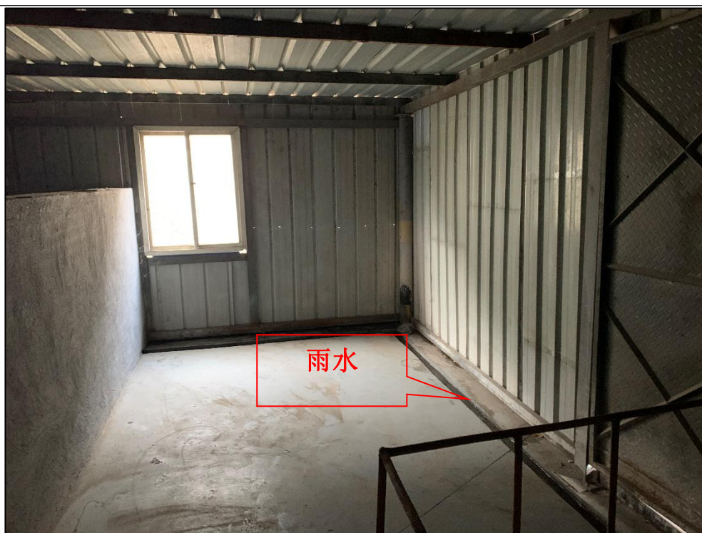
图 2.3-6 危险废物暂存间现状
